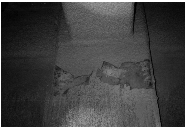
〈그림8〉 콘크리트의 박리
