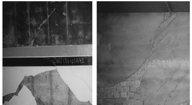
〈그림14〉 철근콘크리트 벽체와 조적 벽체의 손상
