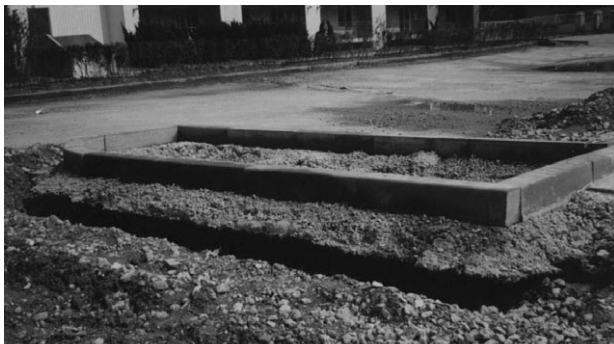
〈그림17〉지하주차장 상부바닥 융기
