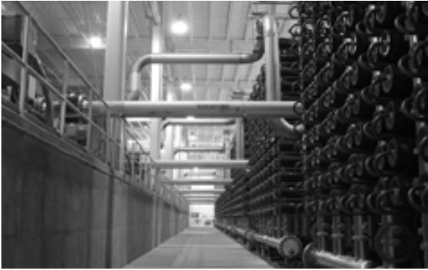
▲ 1,176개의 역삼투압 멤브레인 압력관이 빼곡히 들어찬 시설물 내부
