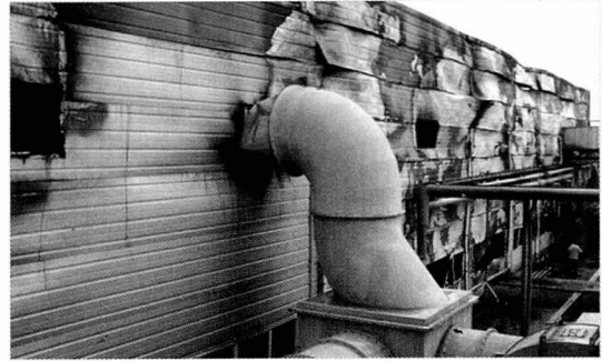
[사진 12] 건물 후미 외벽 소훼된 상태
