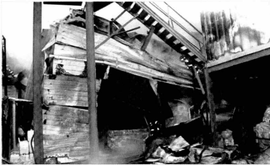
[사진 3] 컨테이너로부터의 출화로 전소되어 함몰된 뒤편 공장 모습
