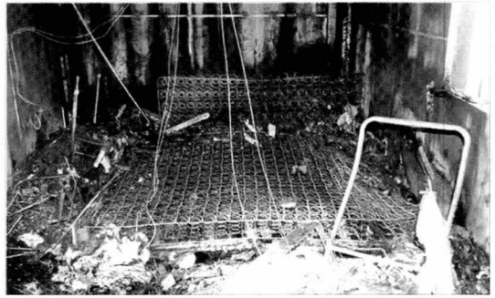
[사진 4] 발화부위로 추정되는 컨테이너 내부 전기온돌장치의 소취모습
