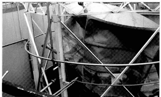
[사진 6] 수소 가스홀더 파손상태
