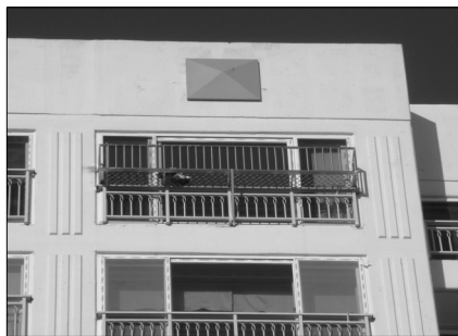
사진 2. 새시선이 화단 바깥쪽으로 불법 설치
