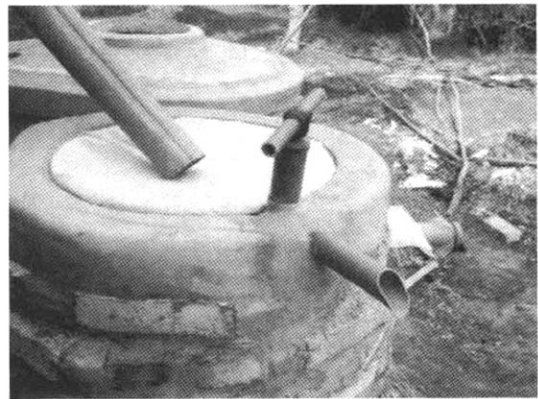
Fig. 5. 수동식 펌프가 설치된 빗물저류 우물(아프리카).
