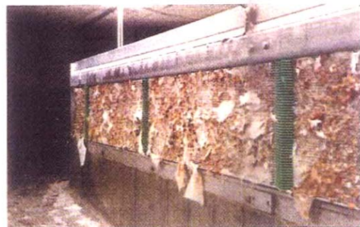
● 雨水中の夾雑物 かき取り装置を停止して捕捉した例
