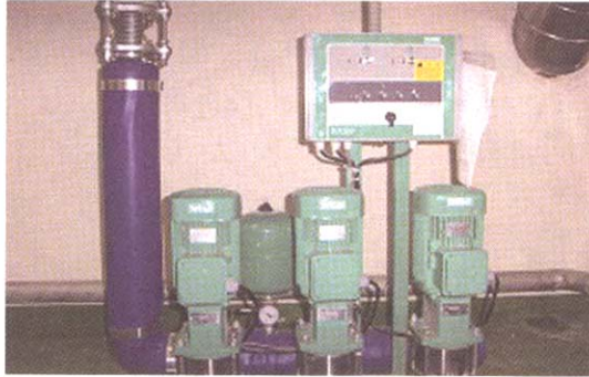
화장실 공급펌프 3대
