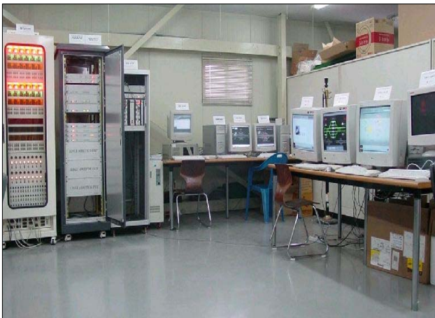
그림 9 통합신호시스템 구축 및 통합시험 현황 Fig. 9 Configuration of Laboratory Testing of kTCS System
