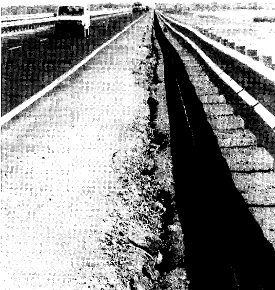
그림 9. 칸들라 항구의 접근로(도로의 중앙부 균열)
