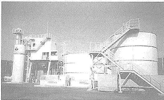
LSS 플랜트 전경
