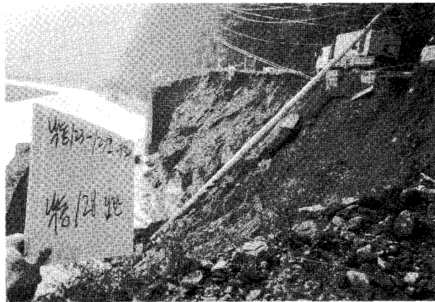
도로유실로 인한 전주도괴
