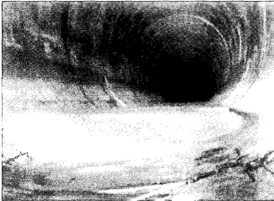
사진 6. Concrete Lining구간 피해 모습
