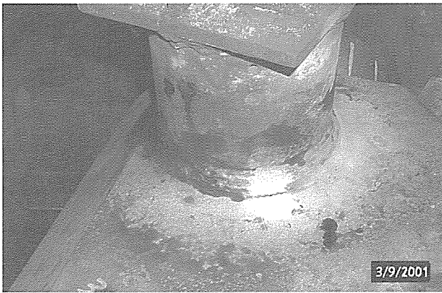
Fig. 5 보조배관 연결부에서의 균열 발생
