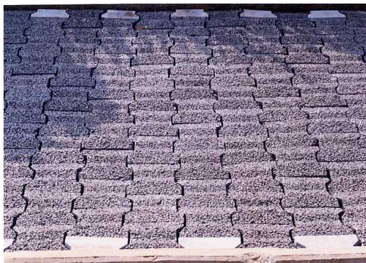
그림 1. 하천 제방 사면에 시공된 다공질 식재 블록
