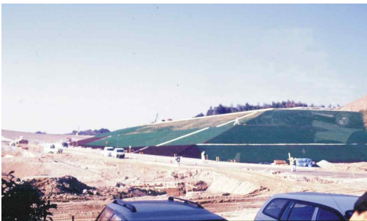
사진 5. 대규모 성토비탈면 발생현황
