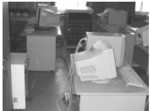
그림 3. 컴퓨터실에 설치된 LAN 및 전원장비(H중학교)
