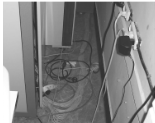
그림 6. LAN장비랙의 후면부 케이블 배선(H초교)
