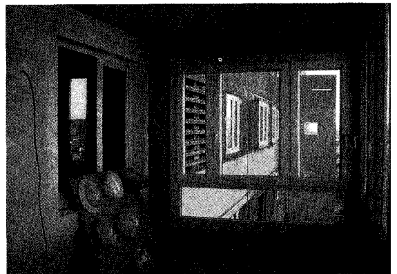
공사중 발코니 내부. 고층부는 강한 바람이 불 때도 있기 때문에 창을 설치해서 방처럼 만들었다.
