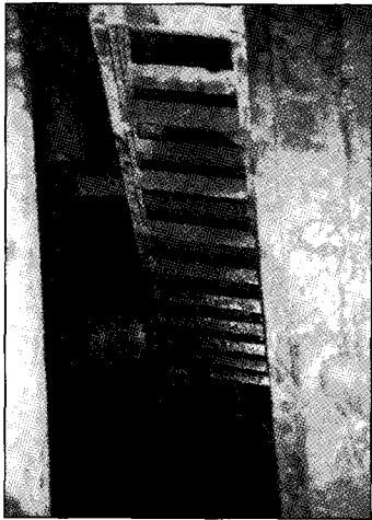
[지하집수조에 설치된 알루미늄사다리]
