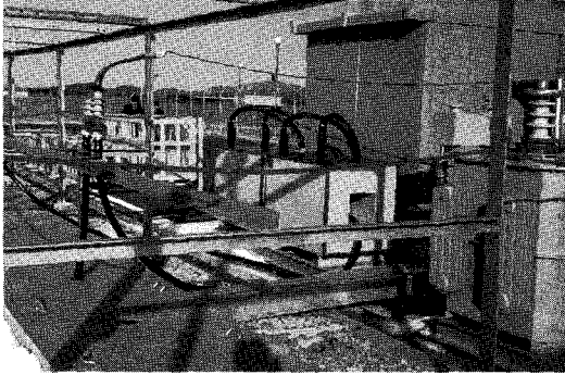
〈그림 8〉 옥외 과동전열화시험설비 부하용 변류기 및 고전압변압기
