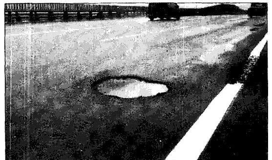
그림 2. 교면포장에 발생한 포트홀 전경
