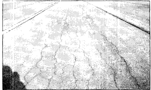
사진 1. 거북등 균열-아스팔트 포장
