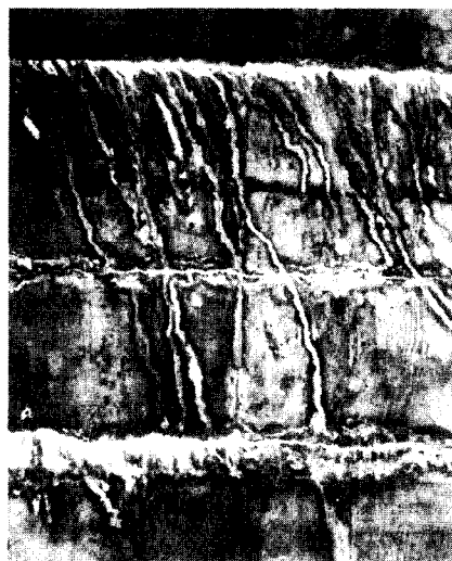
그림 3. 콜로라도주 덴버의 23번가 육교에서 사용된 고강도 콘크리트의 초기 균열 사진
