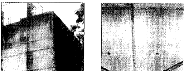
그림 6. 노출 콘크리트 얼룩
