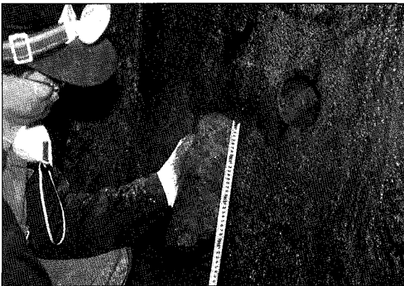
그림 3. 산성수 누수지역의 코어 채취
