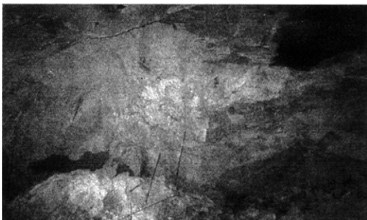
사진 5. 붕락부 막장면 (록볼트 탈락)
