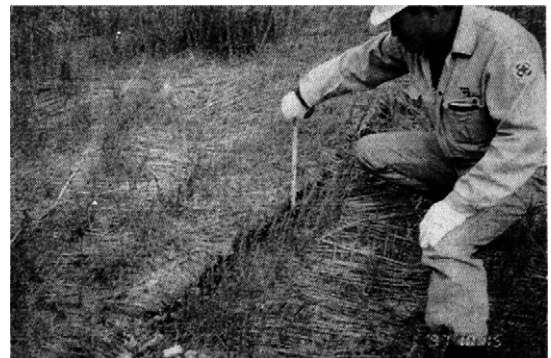
사진 3. 터널상단부 지표면 균열
