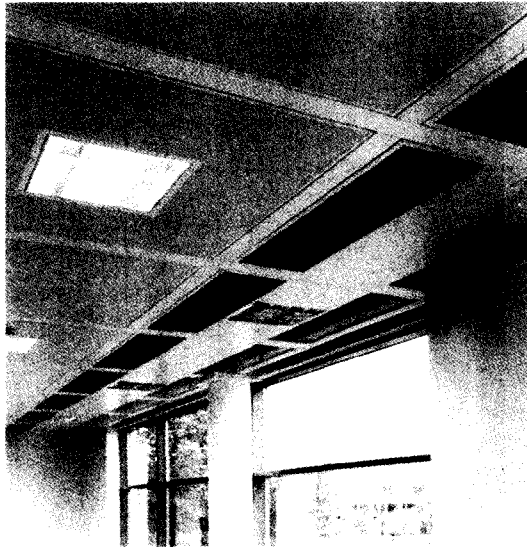
〈그림 3〉 Slough의 227 Bath Road에 위치한 복사냉방패널과 페리메타 존에서의 자연형 Chilled beam
