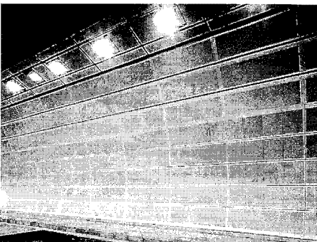
그림 6. 흡음판의 터널 내부의 설치 예
