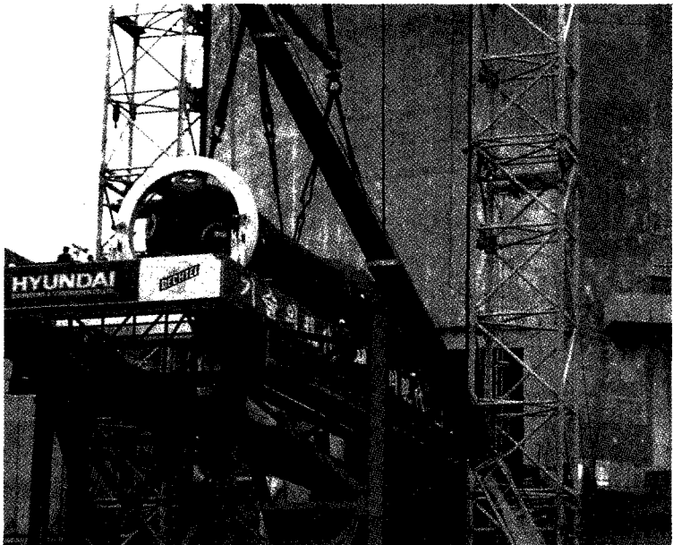
고리 1호기 증기발생기 교체 작업. 세계 원전 시장으로 급부상하고 있는 중국 및 동남아시아 지역으로 우리의 원전 건설 기술의 진출을 활발히 추진하여, 명실공히 세계 속에서의 원전 건설 업체로 발돋움하고 국내 원자력 산업의 재도약 및 발전에 크게 이바지 하고자 하는 것이 현대건설(주)의 최대 목표이며 당면 과제로 인식하여 모든 노력을 경주하고 있다.
