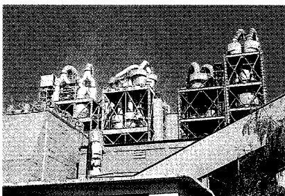
아시아시멘트 제천공장에 설치한 전기집진기
