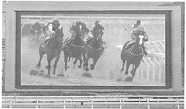
▲ 과천 경마장에 설치된 형광램프형 풀 컬러 전광판
