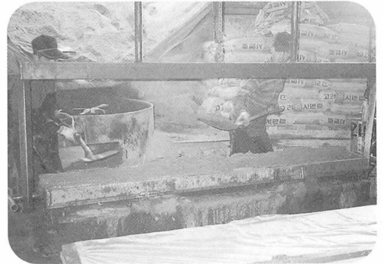
▲▲콘스라트 모형에 맞추어 철근을 용접하는 장면 ▲콘스라트 모형의 금형틀에 용접된 철근을 넣고 콘크리트를 부어 성형하는 장면
