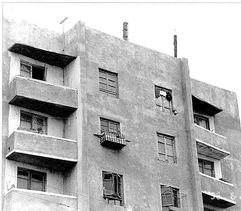
북한 함경북도 나진시내 중심가 복합건물의 아파트 일부 — 건물내에는 상점, 목욕탕, 미장원, 유아원, 아파트 등이 들어서 있다. ('96. 6. 27촬영 / Minolta 700SI 24~85mm) 사진제공 : 한중연 회원(중합건축사사무소 금성 대표)
