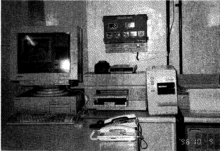
방사선 작업 관리 전산시스템(모니터, 프린터, Bar Code 및 Bar Code 인식기, Hand Held Terminal)
