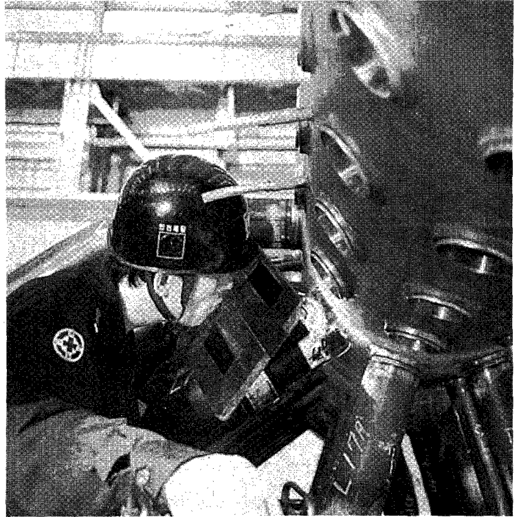
초기 국산화 품목인 월성 3호기의 Feeder Header Frame Assy의 Upper Feeder Frame 오접 장면
