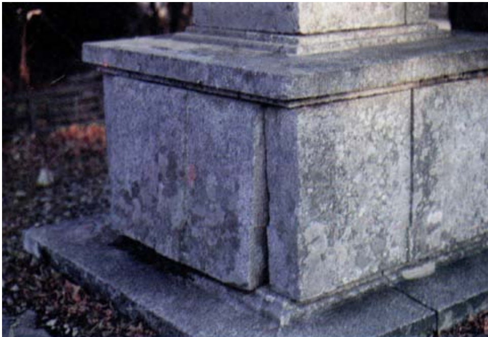
사진 12. 面石이 떨어진 상태(榮光 新川里三層石塔)
