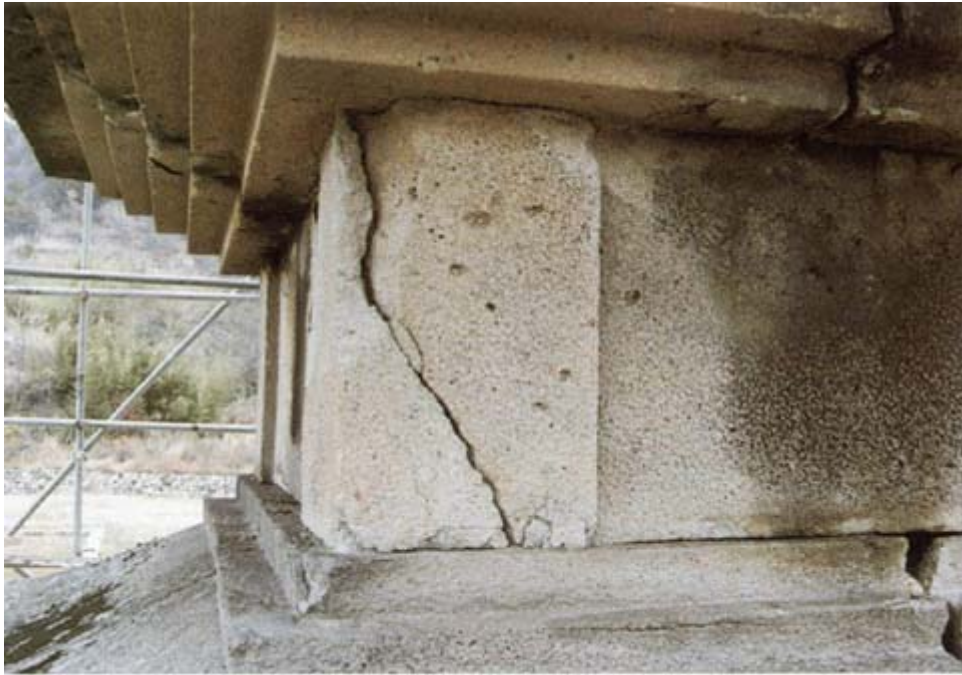
사진 7. 隅柱가 압축파괴된 상태(感恩寺址 東塔)
