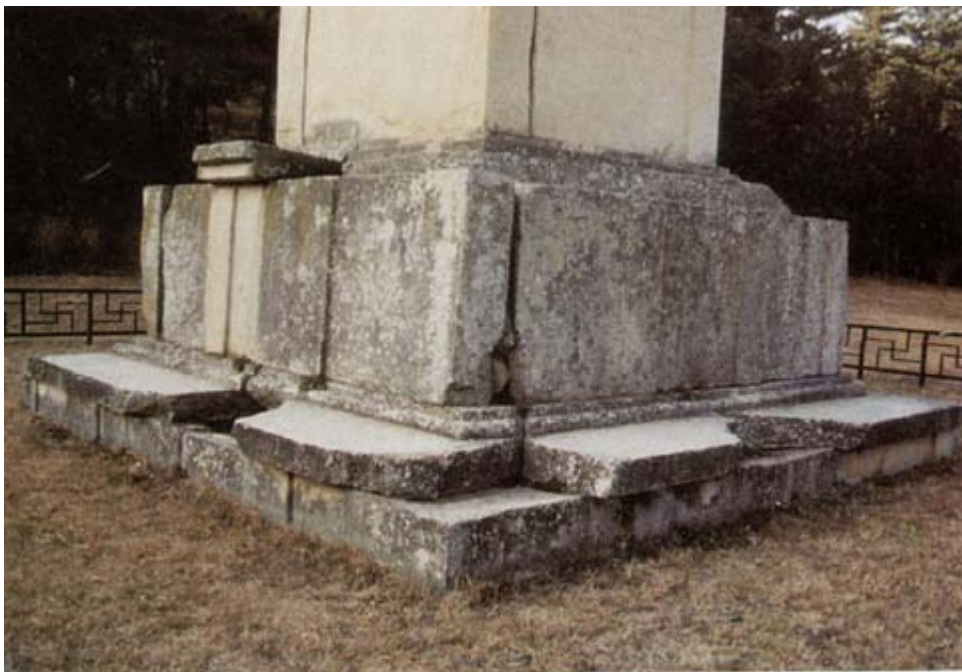
사진 8. 積心沈下로 기단갑석이 파손유실된 현상(羅原里五層石塔) 의리산사지 羅原里五層石塔
