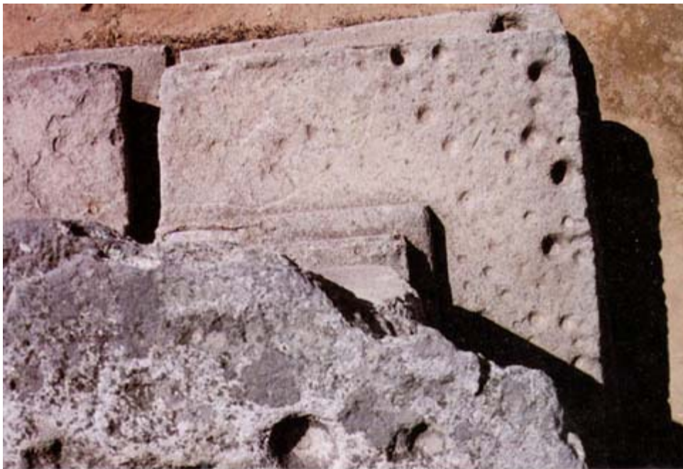
사진 14. 甲石에 발생된 구멍(感恩寺址 東塔) 갑석 感恩寺址 東塔
