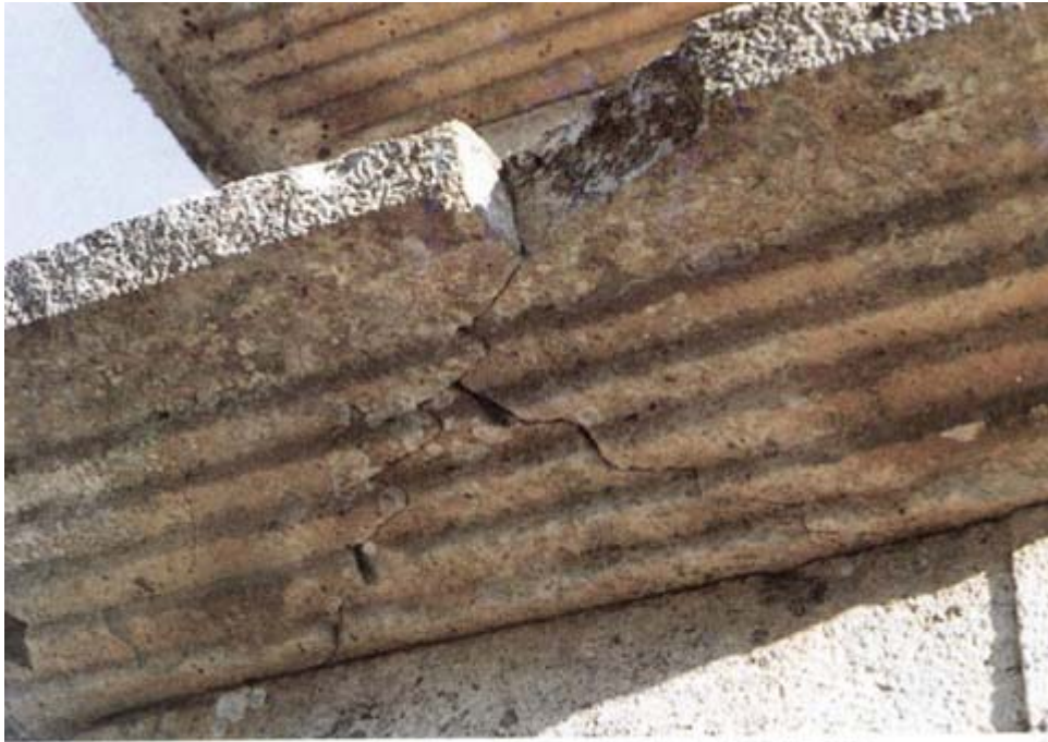
사진 5. 옥개석의 균열파손(長興 寶林寺東三層石塔)
