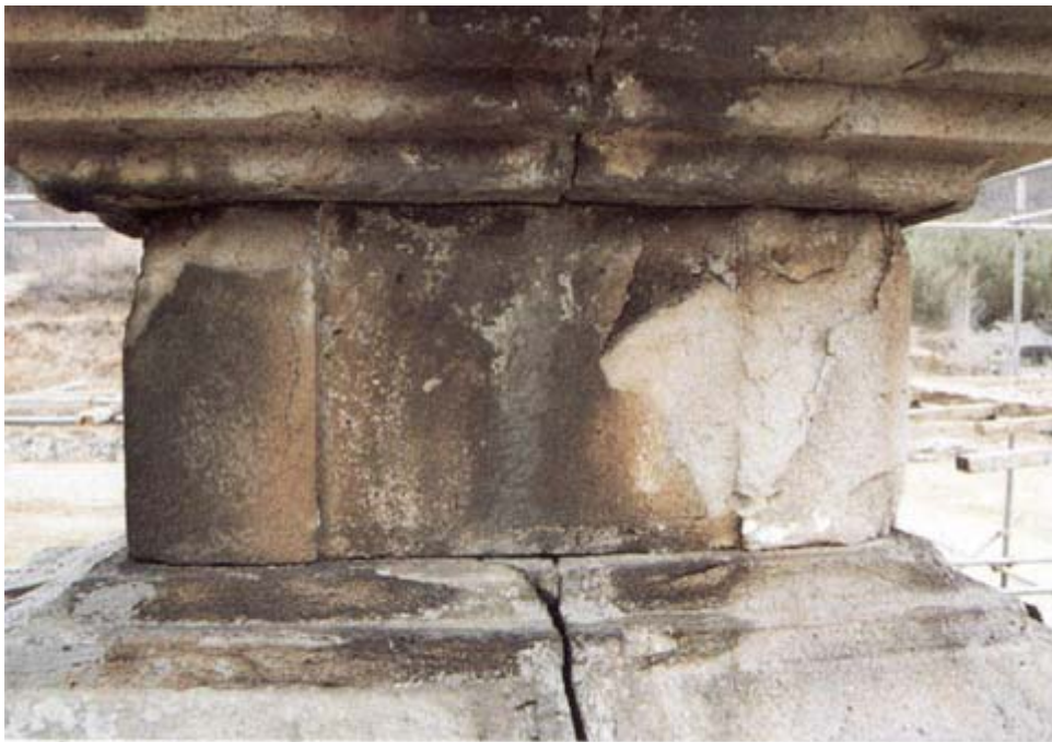
사진 6. 落水로 석재표면이 풍화 손상된 상태(感恩寺址 東塔)
