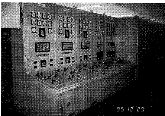
▲ 백령도 디젤발전소에 설치된 발전기
