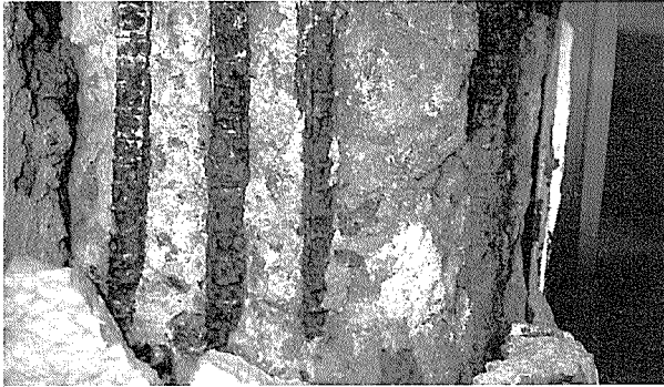
사진 1 철근부식에 의한 피복콘크리트 탈락
