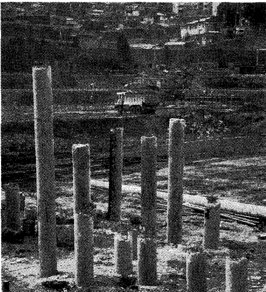
〈그림 3〉 PC말뚝의 頭部損傷
