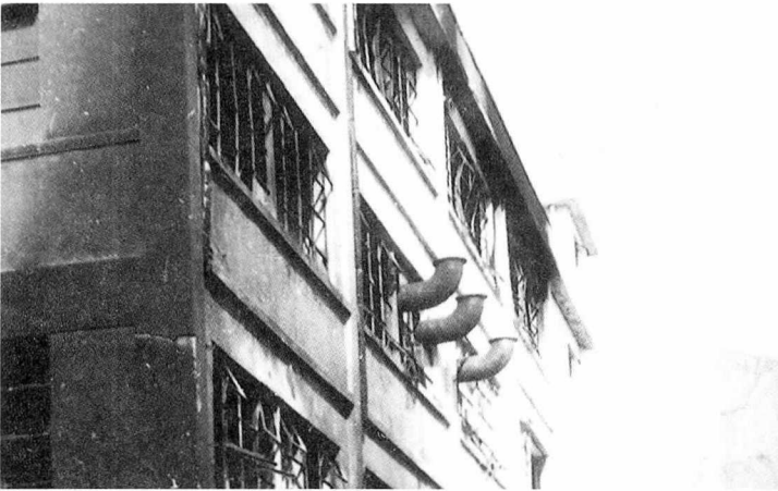
〈사진 3〉 3층 외부로 나온 강관의 용접작업중 볼티가 건물 밖으로 떨어지면서 쌓아 놓은 스티로폴 더미에서 발화, 건물 외벽에 집중 박리 현상을 보이고 있다.
