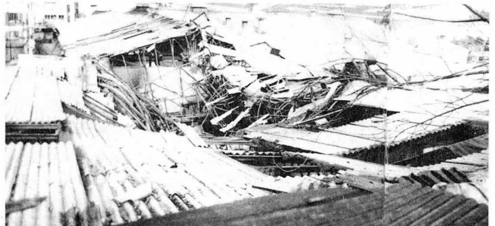
<사진3>화재 현장의 지붕 발소 현상
