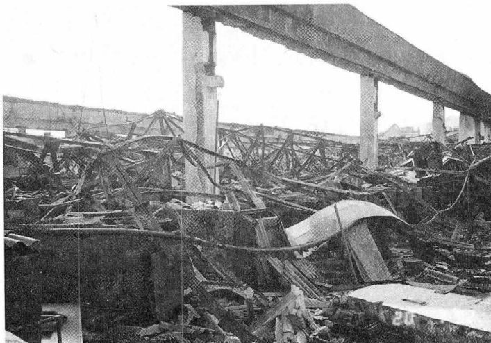
<수열량이 큰 보는 도괴하였으며 철골조 트러스는 완전히 붕괴되었다.>
