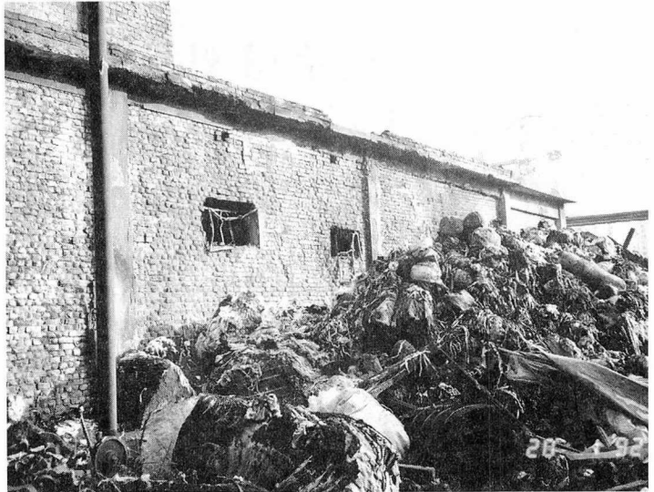
<2층 창고의 지붕이 내려 앉고 재공품은 타서 검게 되었다.> (타고 남은 실물치가 보인다.)
