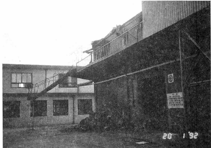
〈모방공장에서 13m 떨어진 창고에 연소 확대되어 2층 지붕이 붕괴되었다.〉
