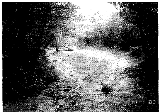
사진 26. 비로사-비로봉사이 등산로주변 통나무흙막이 붕괴 황폐지(상부 표면침식의 확대) (92. 8)
