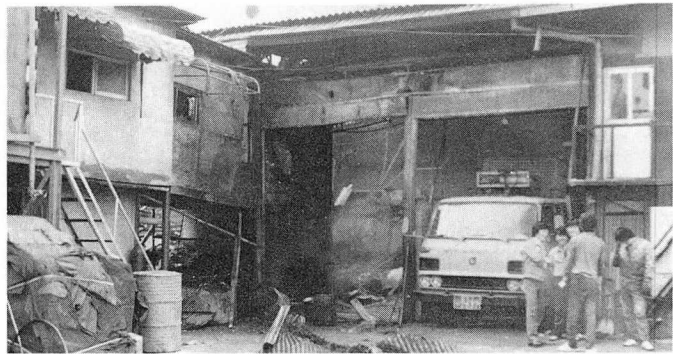
〈사진 1〉 〈그림 3〉과 거의 같은 사진으로 우측 화물차 있는 곳이 G공업사 출입구로 소방이 진입하여 좌측의 블록벽을 파괴하는 소방작업을 한 것이다.
