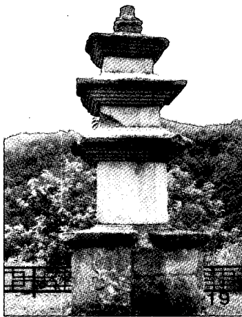
사진 19. 중금리 3층석탑(동탑) : 1층탑신의 가운데 수직으로 갈색으로 보이는 부분은 깨어진 면을 따라 풍화가 더 잘 진행되고 있음을 보여 주고 있음. 기단석과 탑신부분의 암석은 동일한데 풍화정도는 대단히 다름 또한 1층 탑신은 다른 부분에 비하여 비교적 신선함.
