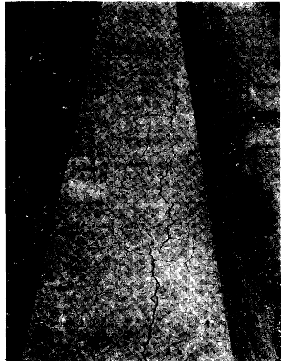
사진3. 알칼리·실리카반응에 의한 균열
