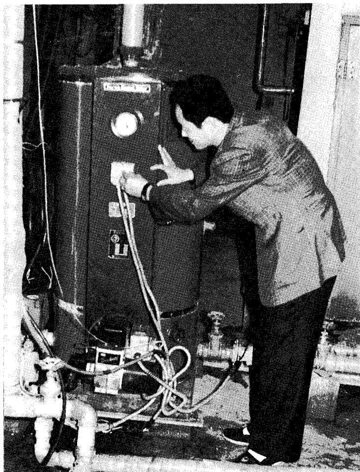
전공장에 자동기계와 보일러가 설치되어 있어...
