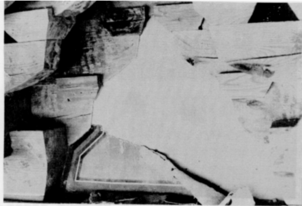
사진 5 . 模寫層의 탈락상태 (건물 후면)
