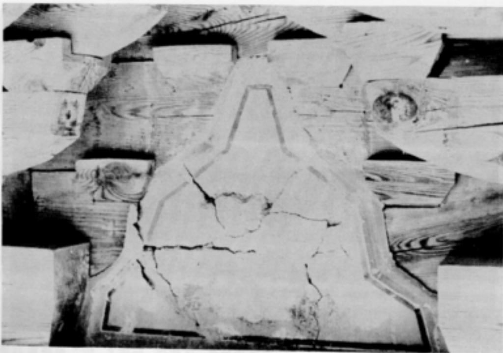
사진 6 . 벽체의 균열, 파손상태 : 건물의 퇴락과 변위에 의한 충격이 벽화에 전달되어 균열 파손되었음 .
