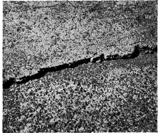
〈사진-5〉 新舊 콘크리트 연결부의 파손
