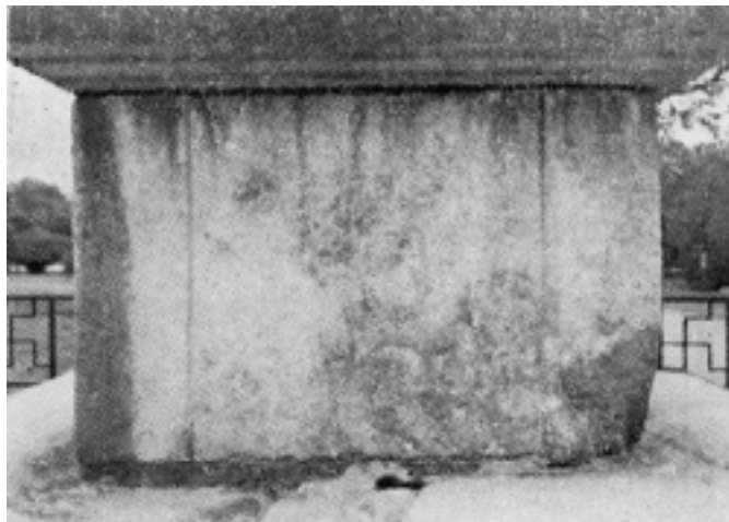
사진 5. 풍화에 의하여 표면이 떨어져나갔으며 석재 사이의 습기에 의하여 부분적으로 심하게 풍화되어 있는 현상과 석재 사이의 틈에 잡초가 번식하여 풍화를 촉진시키는 현상.
