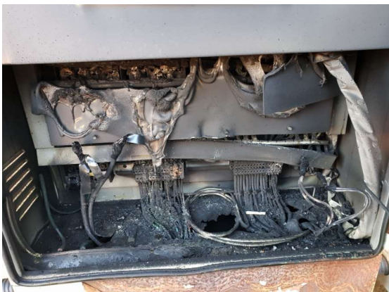
그림 3 태양광 DC 접속반 화재 Fig. 3 Photovoltaic DC junction board fire
